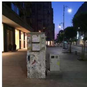
Img. 6 Calea Victoriei – lățirea originală a trotuarului a lăsat în urmă transformatorul electric și cutia de distribuție.
