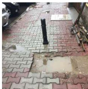
Img. 9 Lucrări nesemnalizate/ mentenanță defectuoasă, Strada George Enescu.
