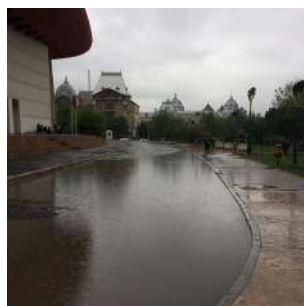
Img. 12 Pantă de scurgere insuficientă pentru strada de acces la TNB, reabilitată de curând.
